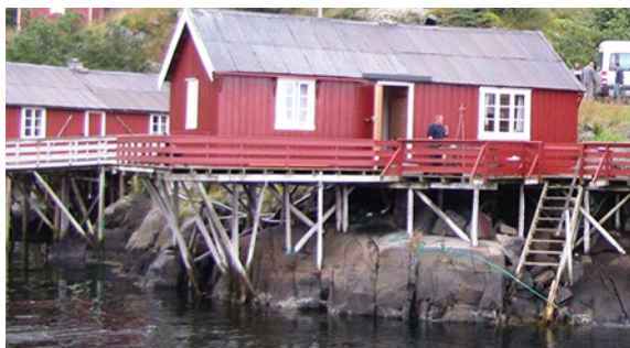
Figur 13 Eksempel som viser direkte utslipp av urensset avløp fra rorbu. (ikke hentet fra Flakstad Kommune). Tydeligvis brukt av turister. Merk utslippsrør under rorbu direkte til sjøen.
