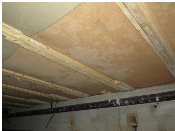
Foto 2. Tydelig muggsoppvekst på undersiden av himlingsplatene i krypekjelleren.
