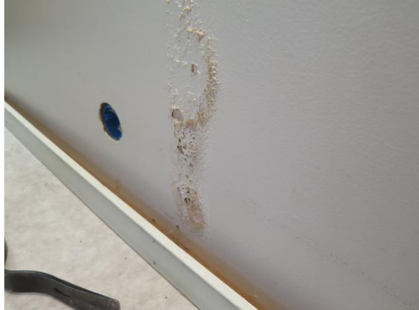
Foto 8. Innvendig side av yttervegg i barnehage. Maling blærer i vegg på innsiden. Noe fuktutslag med fuktindikator.
