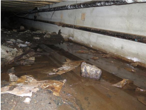
Foto 3. Vann på grunnen i krypekjeller under klasseromsfløy. Muggvekst på materialrester på grunnen.
