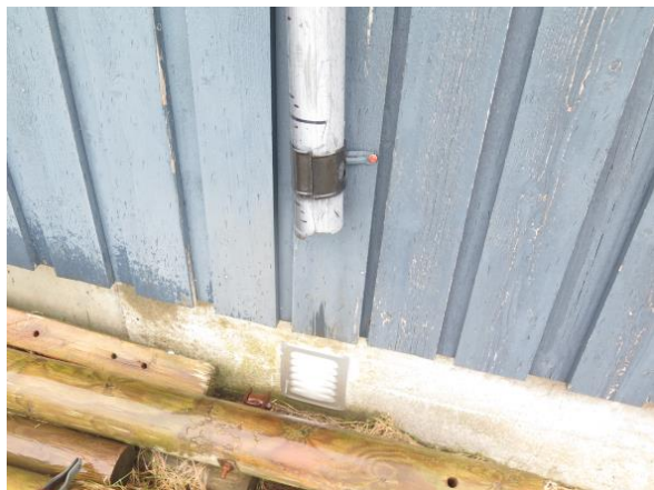
Foto 14. Taknedløp slutter for høyt. Resulterer i oppfukning av yttervegg.
