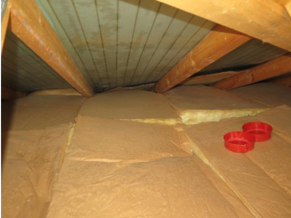
Foto 7. Loft. Isolasjonen er lagt helt ut til skråtaket og begrenser luftutvekslingen.
