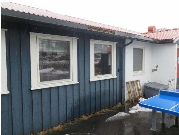
Foto 13. Oppfukning av yttervegg. Defekt takrenne. Det er også skader / manglende beslag mellom taktekking og takrenne.
