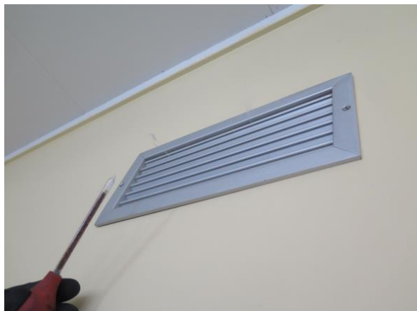
Foto 10. Avtrekkskanaler i hvert klasserom. Med røykappull ble det registrert god trekk.
