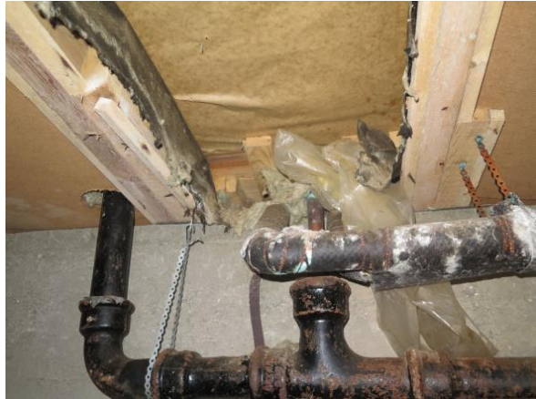
Foto 4. Rørgjennomføringer fra krypekjeller. Luftlekkasjer kan forekomme.
