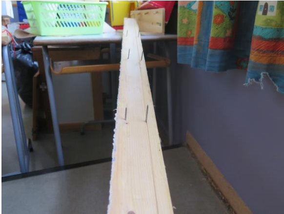
Foto 11. Klasserom. Bakside gulvlist. Ingen tegn til muggsoppvekst.
