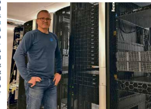
Datasenteret står i et brannskiltet bomberom med ekstra nedkjøling. Men på kalde vinterdager er dette rommet med å varme bygget vakk, så det er gjenbruk av varme, forteller Stig Mannassen, leder for datasenteret hos Serit Tromsø.
